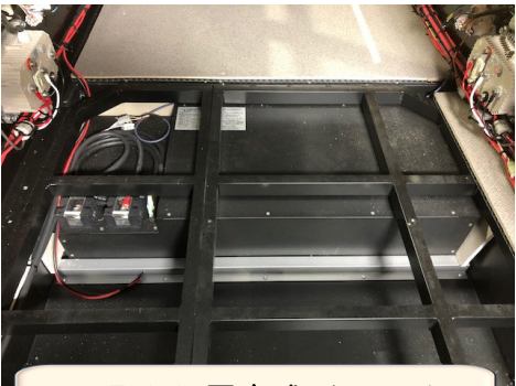
11.5kWh固定式バッテリー
