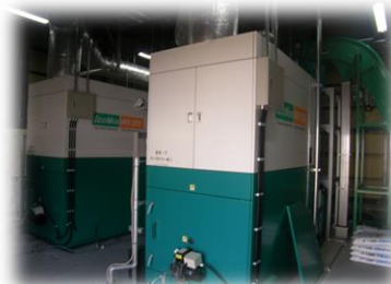
木質チップボイラ
