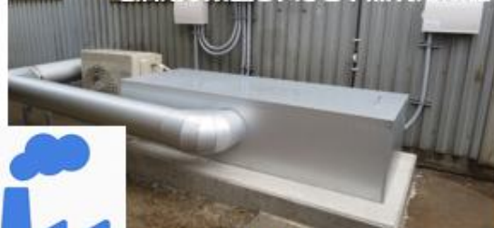
「山口県産 省・創・蓄エネ関連設備登録制度」 を活用し設置された地中熱利用設備
