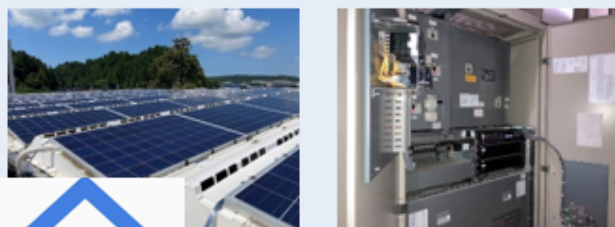
石川県珠洲市の太陽光パネル・蓄電池 (震災時の行政機能維持)
