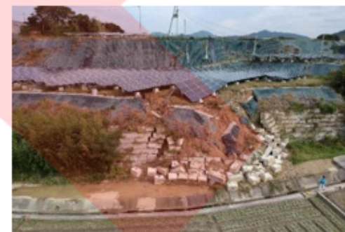
法面保護工が崩れて流出した事例
