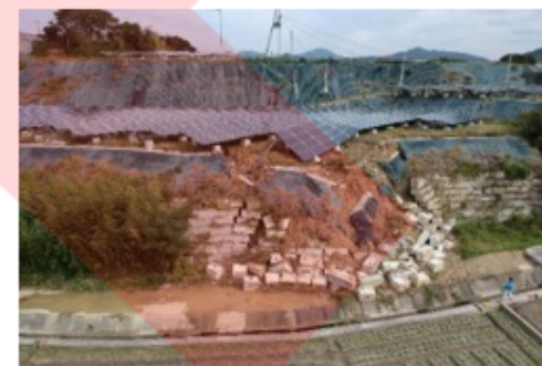
法面保護工が崩れて流出した事例
